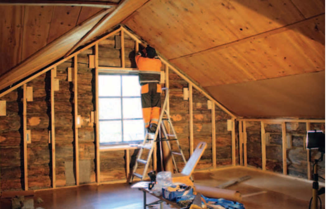
Härkäselässä tarkistetaan koolauksia ja osa sisäkatosta on suojattu, jotta puhallettava eristysmateriaali ei aivan joka paikkaan päädy.
